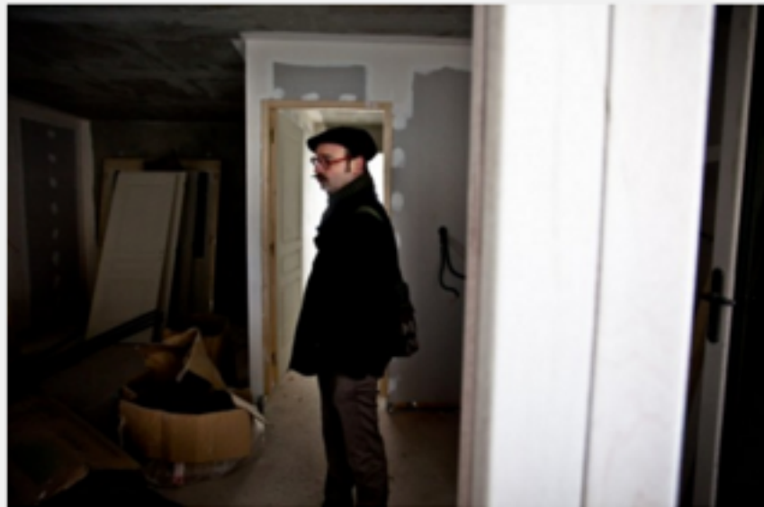
Dans un des appartements du "Village vertical", encore en travaux. © Antonin Sabot / LeMonde.fr
